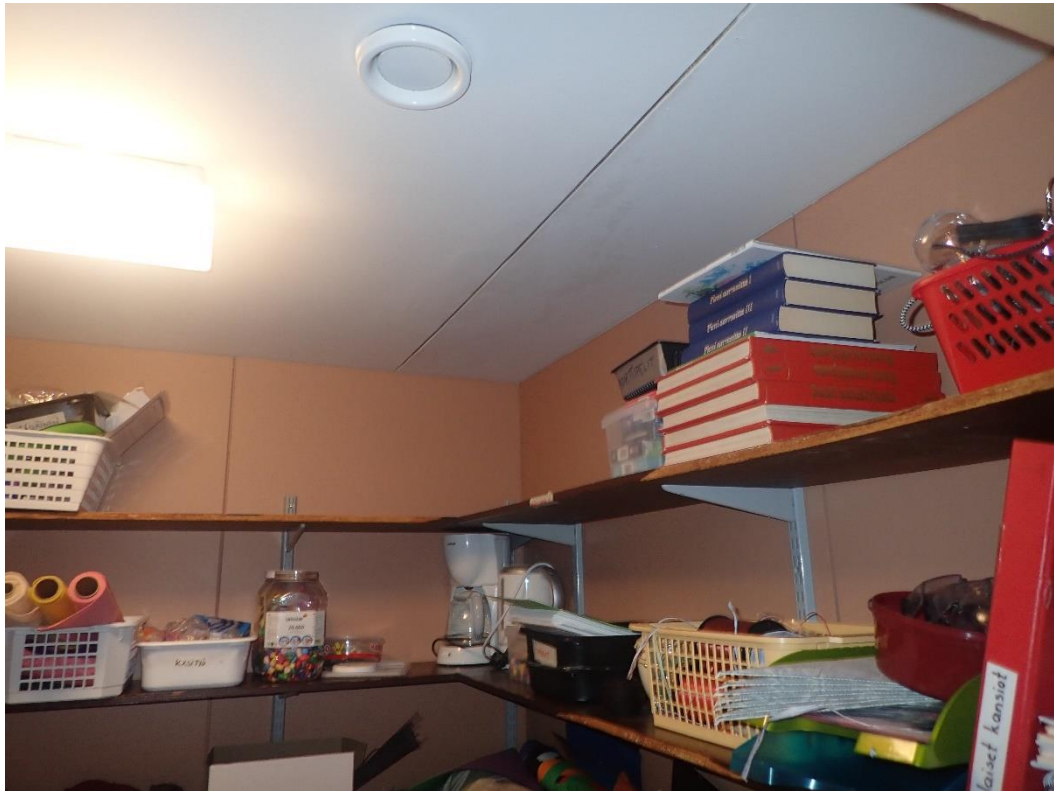
Kerhon tarvikevaraston sisäkatossa on havaittavissa vesijälkiä.
