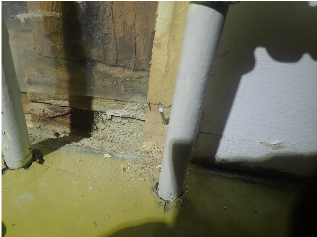
Ulkoseinän sisäpuolinen höyrynsulkumuovi päättyy noin 5-10cm ennen lattiapintaa. Puuosissa oli havaittavissa kosteuden aiheuttamia pitkäaikaisia jälkiä kuten lahoa. Kuva opetustilan rakenneavauksesta RA7.
