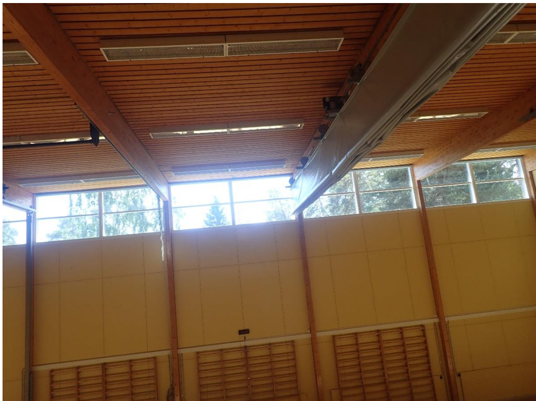
Urheilusalin kannatinpalkkien päissä oli havaittavissa vanhoja vesijälkiä
