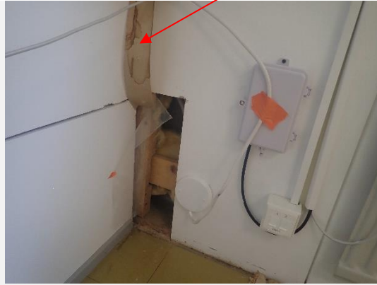
Näyte U8 otettiin opetustilan ulkoseinästä sisäverhoislevyn saumapahvista, RA8.
