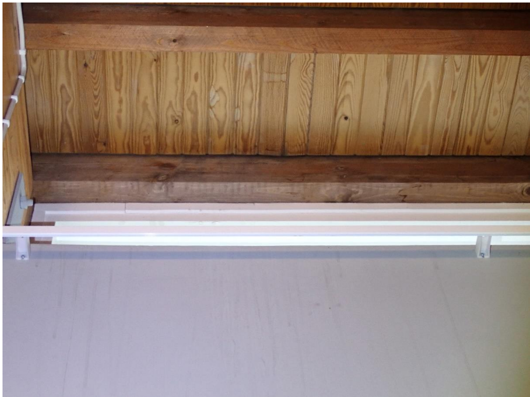
Valtuustosalin katon ja seinän rajasta näkyy valuneen vettä jossain vaiheessa.
