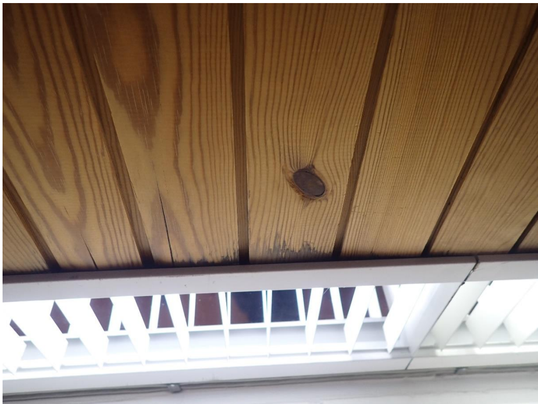
Ylemmän kerroksen käytävällä valaisimien reistä on valunut vettä
