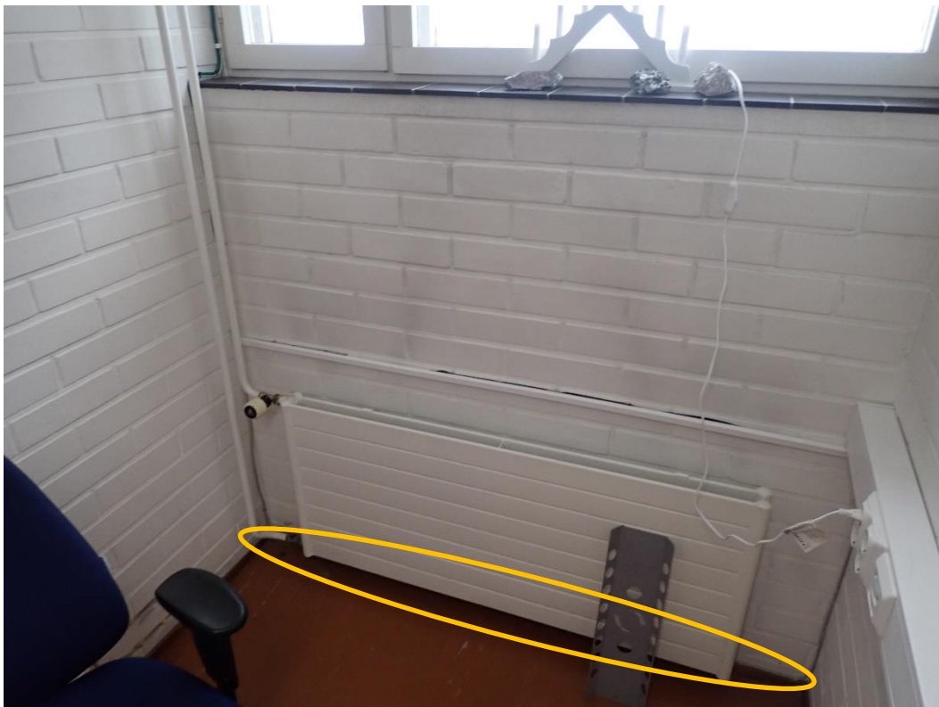
Alemman kerroksen käytävän päässä oli havaittavissa kosteuden aiheuttamia jälkiä
