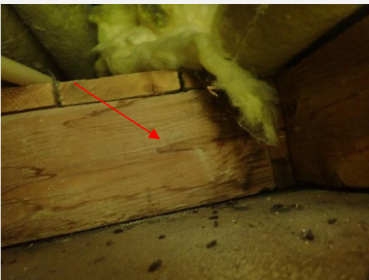
Näyte NK5 on otettu nuorisotilan miesten wc:n sisäkattorakenteesta, RA5.
