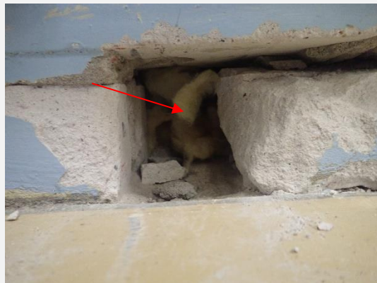
Näyte NK4 otettiin salin ulkoseinän eristeestä, RA4.
