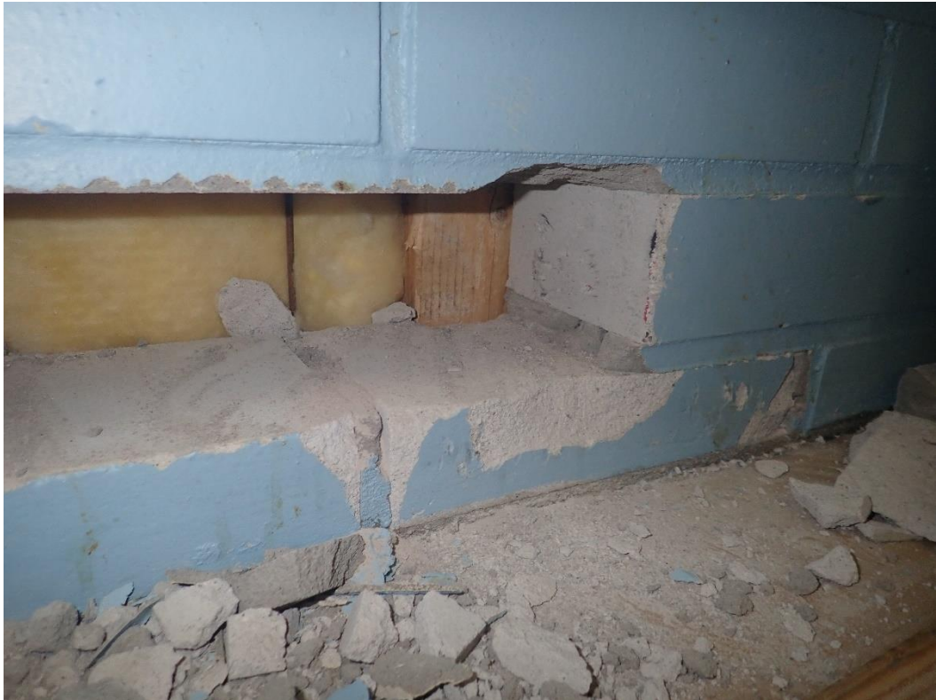
Rakenneavauksista havaittiin ilmavuodon aiheuttamaa tummentumaa eristeissä. (RA1).
