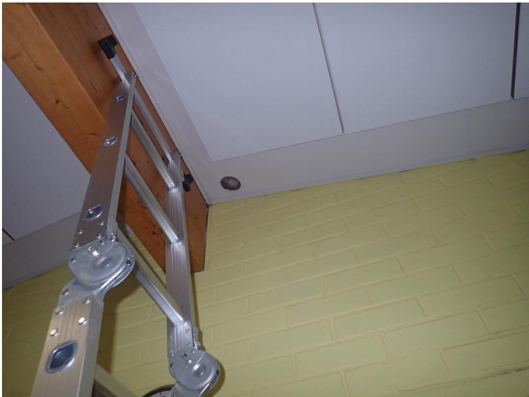
Yläpohjaan tehtyjen avausten kautta havaittiin selkeää ilmavuotyyoa ja vedon tunnetta kantavan palkin vieressä. (RA3).
