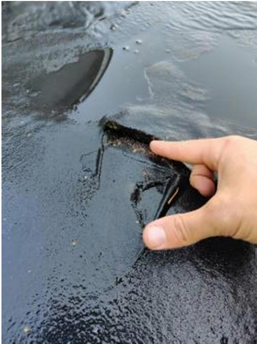
Kuva 67 Vesikatolle myöhemmin asennettu pinnoite oli revennyt monin paikoin. Vesi lammikoitui sateella vesikatolle.
