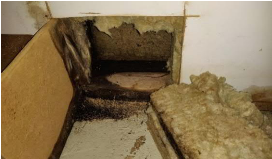
Kuva 24. Varastohuoneen seinärakenteen sisäpuoliset koolaukset ja eristeet olivat silminnähden kastuneet ja mikrobivaurioituneet.
