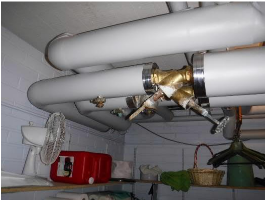
Kuva 84. Lämmönjakohuoneen karaventtiilissä oli liitosvuoto.
