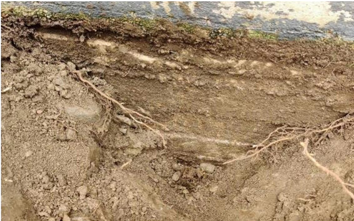
Kuva 7. Rakennuksen ulkopuolelle kaivettu koekuoppa. Täyttömaa rakennuksen vierustalla oli hie- noaineista, eikä muurin pinnassa ollut vedeneristystä.
