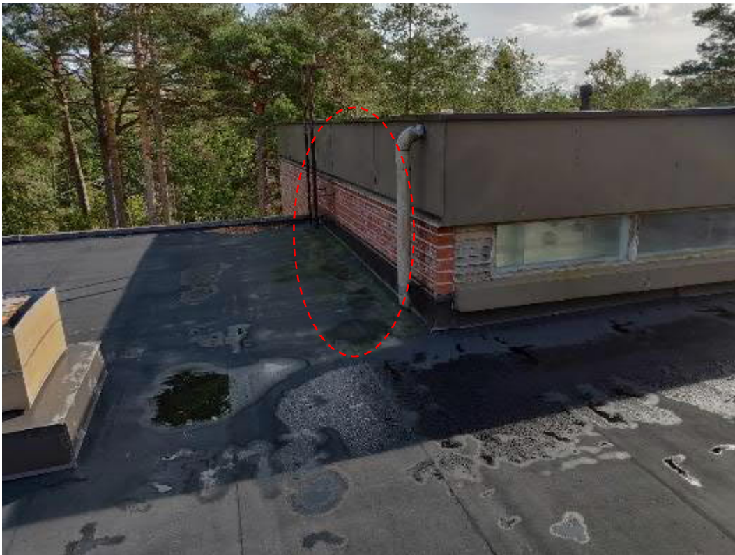
Kuva 64. Vedenpoisto istuntosalin korkeammalta katolta alemmalle tasolle. Tällä kohtaa rakenne vuotaa vettä sisään.
