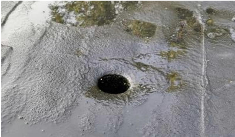
Kuva 10. Vesikaton sadeveden poisto oli toteutettu matalalla katto-osuudella sijaitsevilla sisäkai-voilla. Yhdestä kaivosta puuttui roskasihti, mikä saattaa aiheuttaa poistoputken tukkeutumista.
