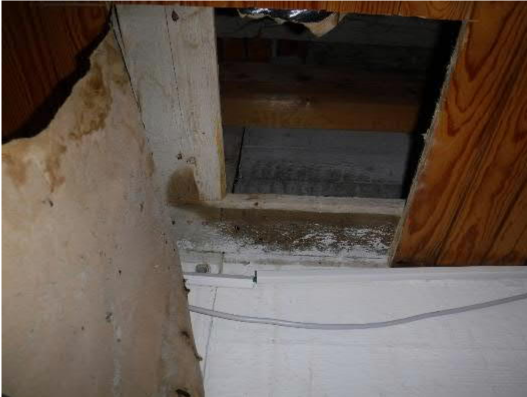
Kuva 68. Käytävällä kunnanjohtajan huoneen kohdalla yläpohjarakenteessa oli tuoreita kattovuodon aiheuttamia vesijälkiä. Höyrynsulkuna käytetyn voimapaperin liitokset ovat epätiivitä rakenteisiin.
