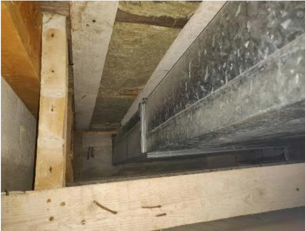
Kuva 83. Ilmanvaihtokanava käytävän alakattorakenteessa.
