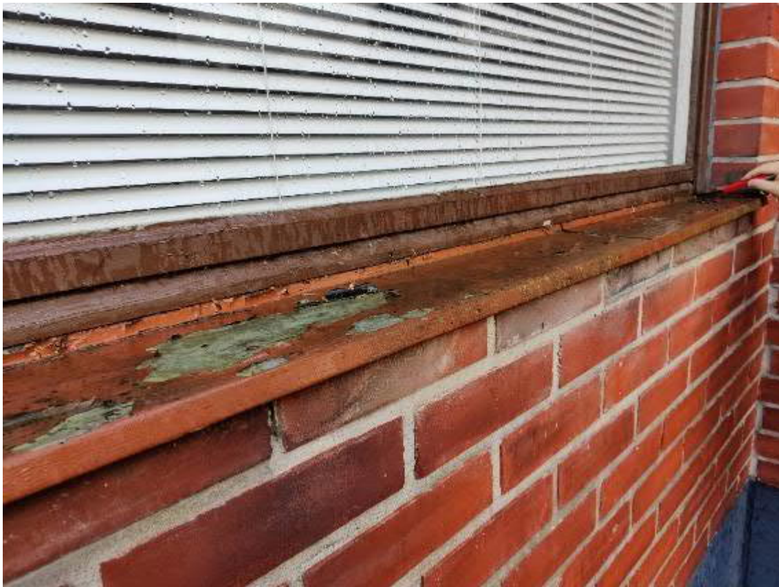
Kuva 52 Ikkunarakenteet olivat alkuperäisiä. Pellitysten kallistukset ovat puutteelliset.
