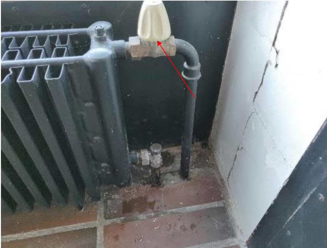
Kuva 85. Tuulikaapin patterin sulkuventtiilissä oli vuoto.
