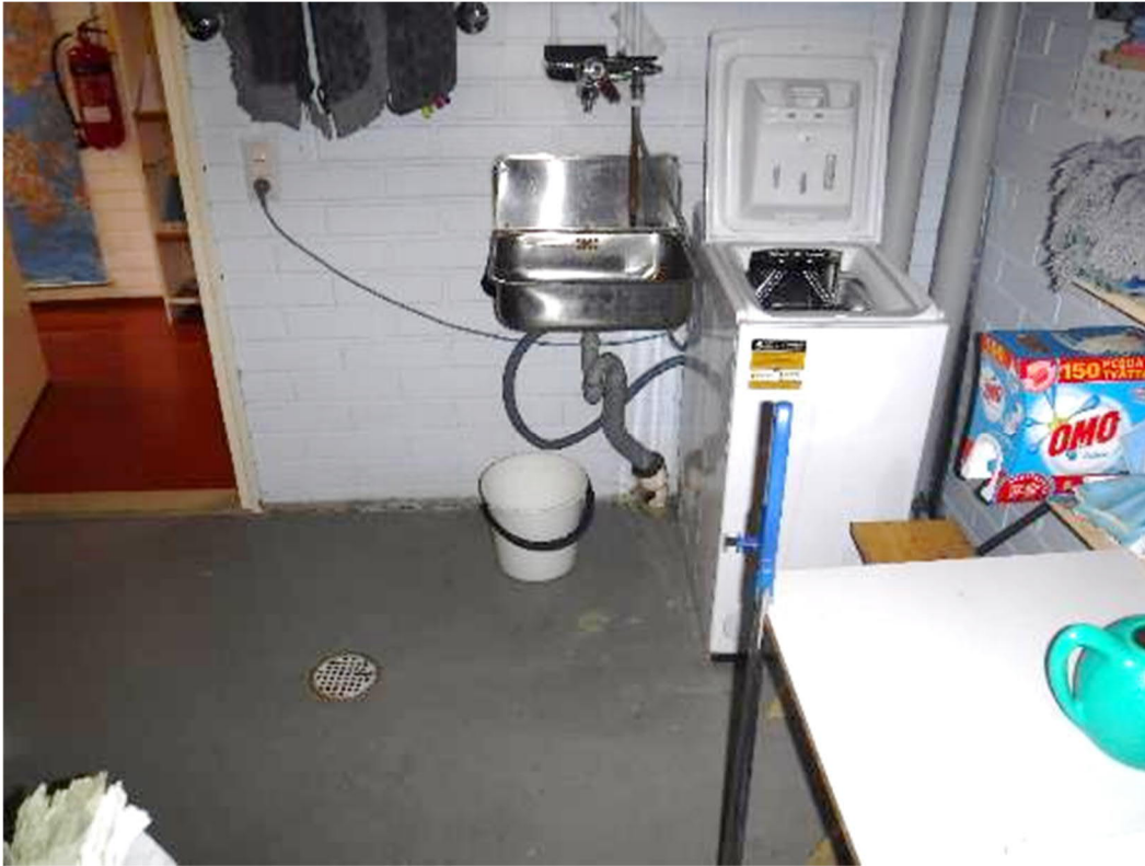
Kuva 34. Lämmönjakuhuone. Lattiakaivollisessa tilassa lattiapinnoite ei ole vesitiivis.
