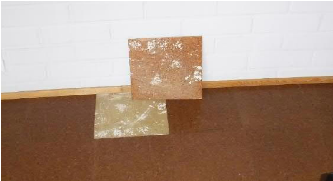
Kuva 41 Istuntosalin korkkilattiasta havaittiin kattovuodon aiheuttama vaurio. Betonilattia on kostea.
