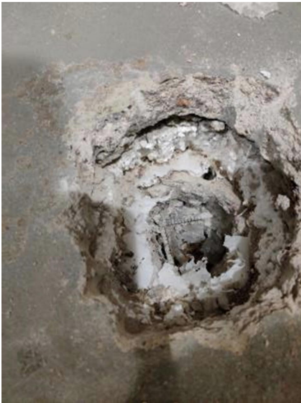
Kuva 35. Alapohjarakenteeseen tehty rakenneavaus A1. Pohjalaatan pinnasta havaittiin muovikalvo. Avauskohdassa muovikalvon ja EPS-eristeen välistä havaittiin kosteutta, joka johtui avauskohdan yläpuolella vuotavasta putkiliitoksesta.
