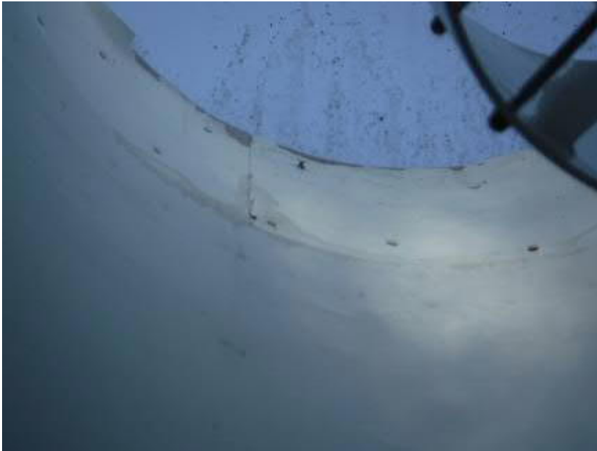
Kuva 74 Kattoikkunoiden sisäpuolisissa vaneripinnoissa havaittiin kosteuden aiheuttamia kuivuneita vauriojälkiä.
