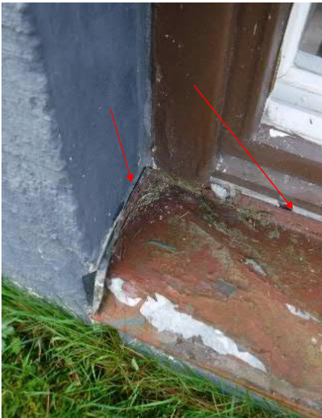
Kuva 54 Kellaritilojen ikkunoiden pellityksissä havaittiin puutteita kallistusten ja tiiveyksien osalta.
