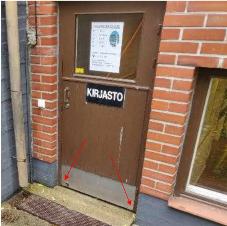
Kuva 57 Kirjaston ulko-oven karmiliitokset jatkuvat betonilaatan alle. Ovenkarmien alaosien puura- kenteet ovat kosteusvaurioituneet.
