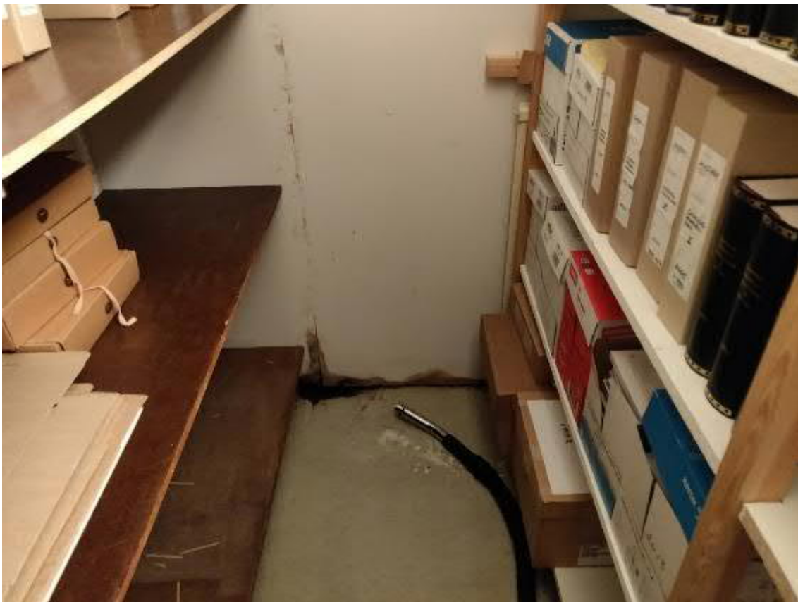
Kuva 23. Varastohuoneessa maanvastaisen seinän sisäpuolelle koolattu seinä oli pahoin mikrobi- vaurioitunut ja märkä koko varaston alueella.
