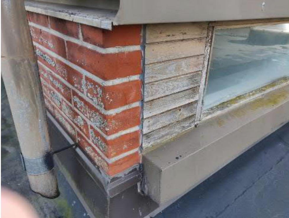
Kuva 50 Ulkoseinärakenteet US2 ja US4. Korkeamman katto-osan rakenteissa havaittiin puutteita rakenneliittymien tiiveyksissä.
