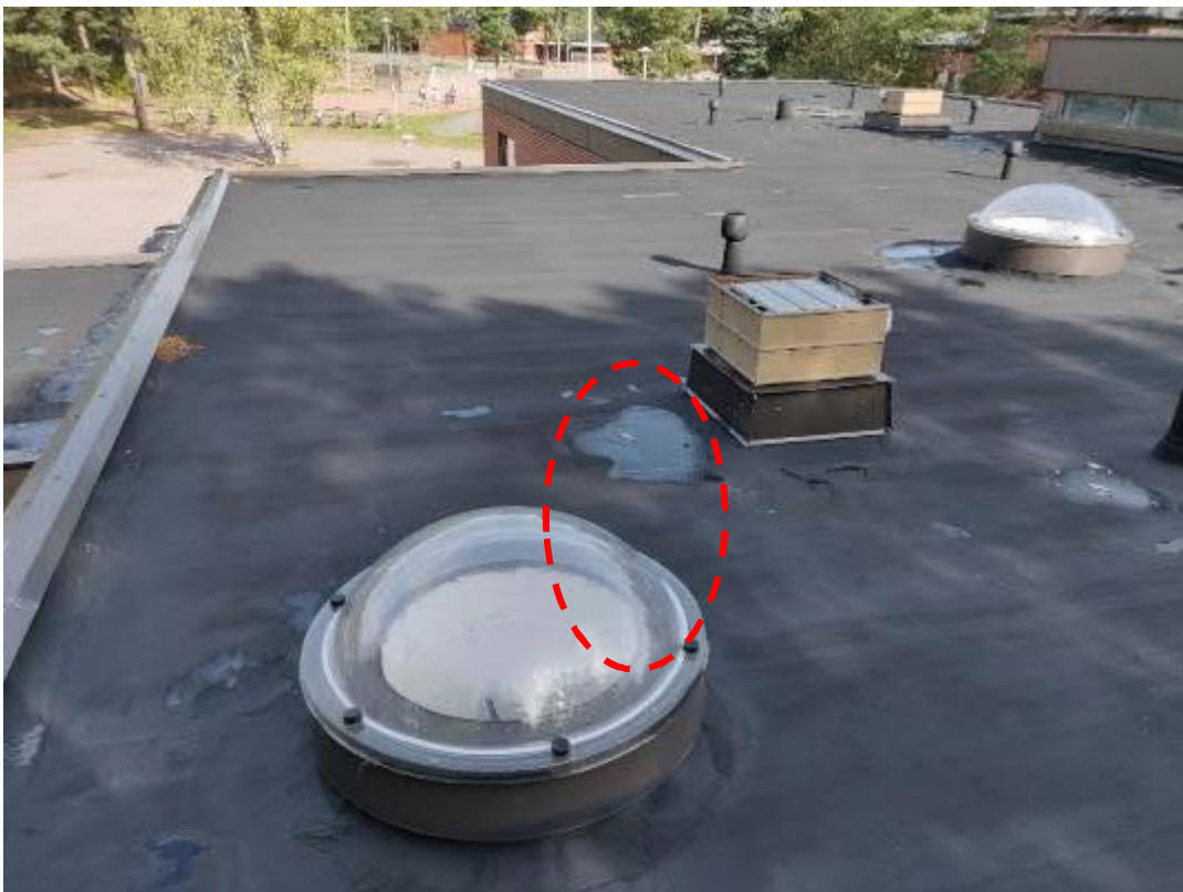
Kuva 66. Eteisaulan wc:n katon vuotokohta on tällä alueella. Kattopinnoitteessa ei näkynyt selvää vuotokohtaa.
