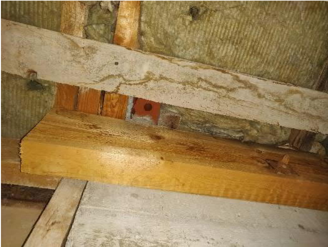
Kuva 69. Käytävällä yläpohjarakenteessa oli kosteusjälkiä. Villaeristeissä on aktiivinen mikrobikasvusto.
