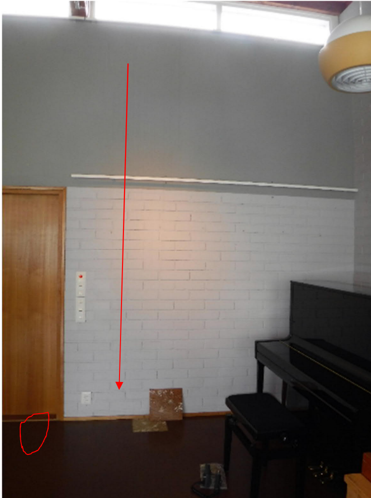
Kuva 40. Istuntosalin seinässä on valumajälkiä, josta vettä on valunut lattiapinnoitteiden alle.
