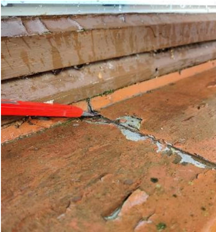
Kuva 55 Ikkunapellitysten väliset liitokset ovat epätiivitä.
