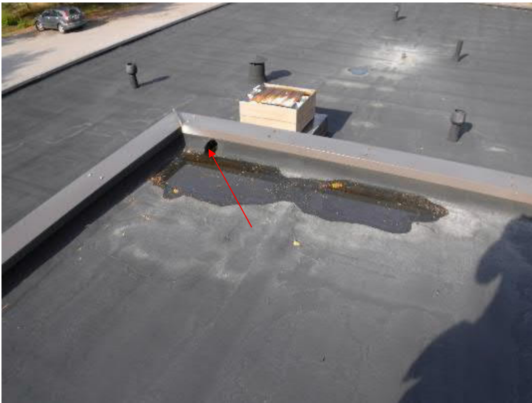
Kuva 65. Vuotokohta istuntosalin sadevedenpoistoläpiviennissä.
