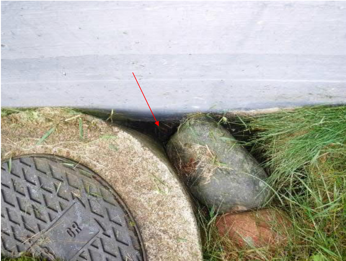
Kuva 8. Rakennuksen pohjoissivulta havaittiin aukko, josta oli suora yhteys rakennuksen sokkeliliin- jan alle salaojan tarkistuskaivon vieressä, perusmuurissa ei näy anturaa.
