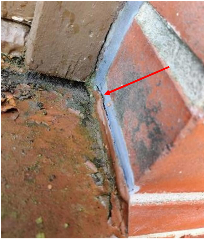
Kuva 53 Ikkunapellitusten liitokset ulkoseiniin olivat monin paikoin epätiivitä. Joitain tiivistyksiä oli tehty jossain vaiheessa.
