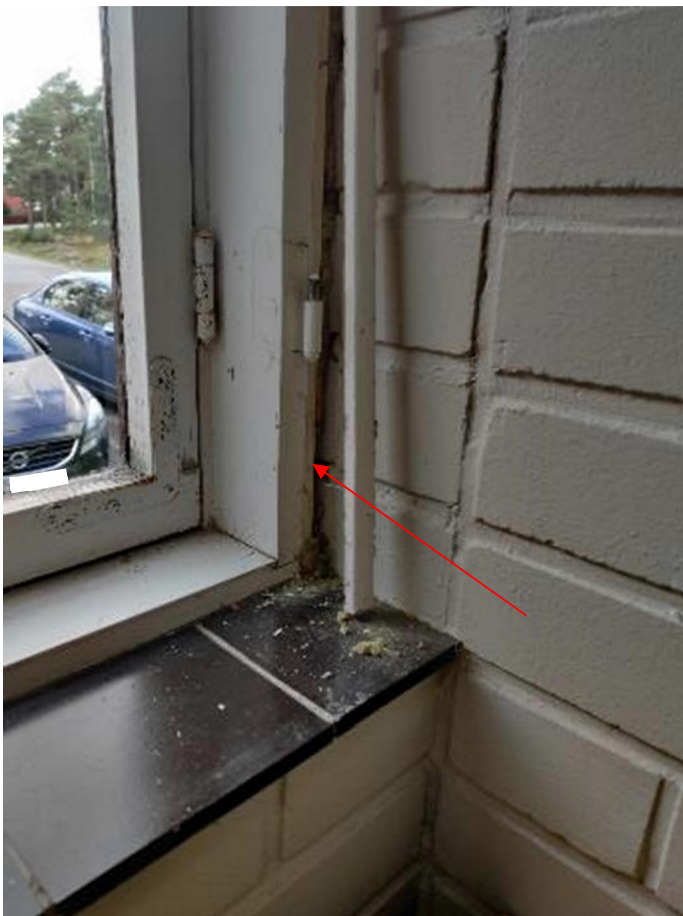
Kuva 56 Ikkunan karmin ja ulkoseinän välisessä lämmöneristeessä oli aktiivinen mikrobikasvusto.
