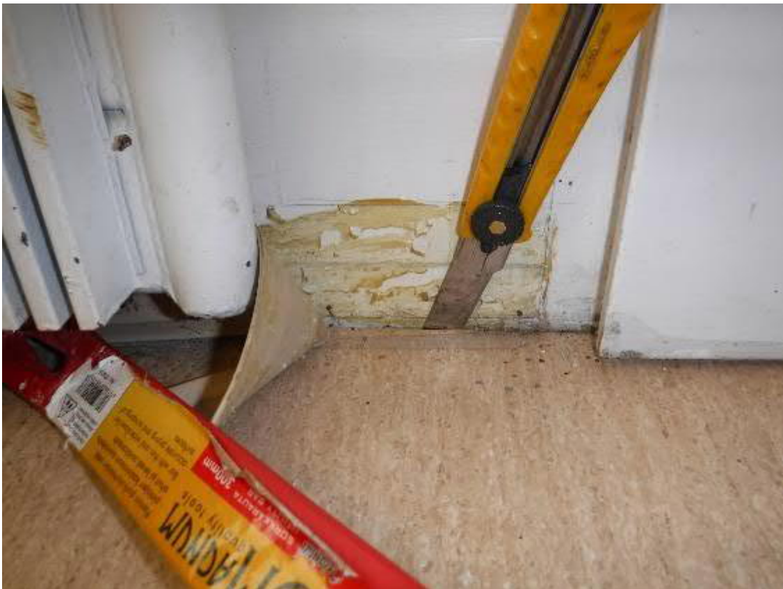
Kuva 37. Alapohjarakenteen pintalaatan ja ulkoseinän väliin oli muodostunut rakoa pintalaatan kuitumisen johdosta. Pintalaatan ja seinän välissä ei ollut käytetty erillistä irrotuskaistaa.
