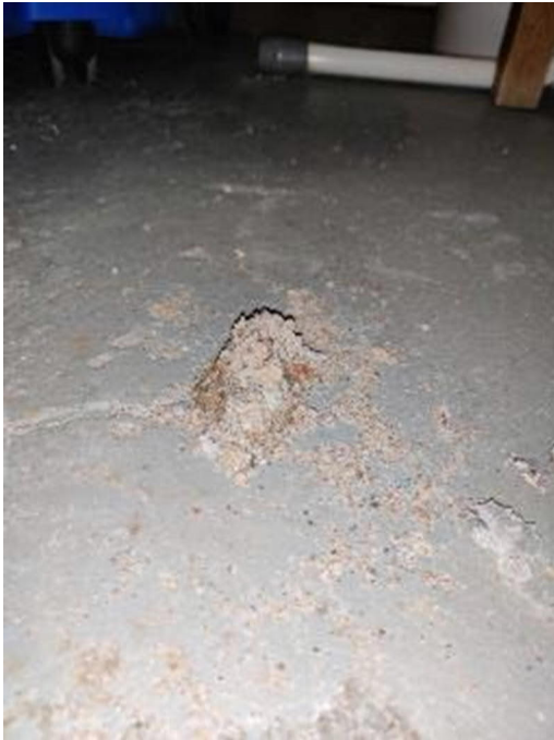
Kuva 36. Alapohjarakenteen AP1 pohjalaatan alla oleva täyttöaines oli hienoa hiekkaa. Hiekkatilan suhteellinen kosteuspitoisuus oli lähes 100%.
