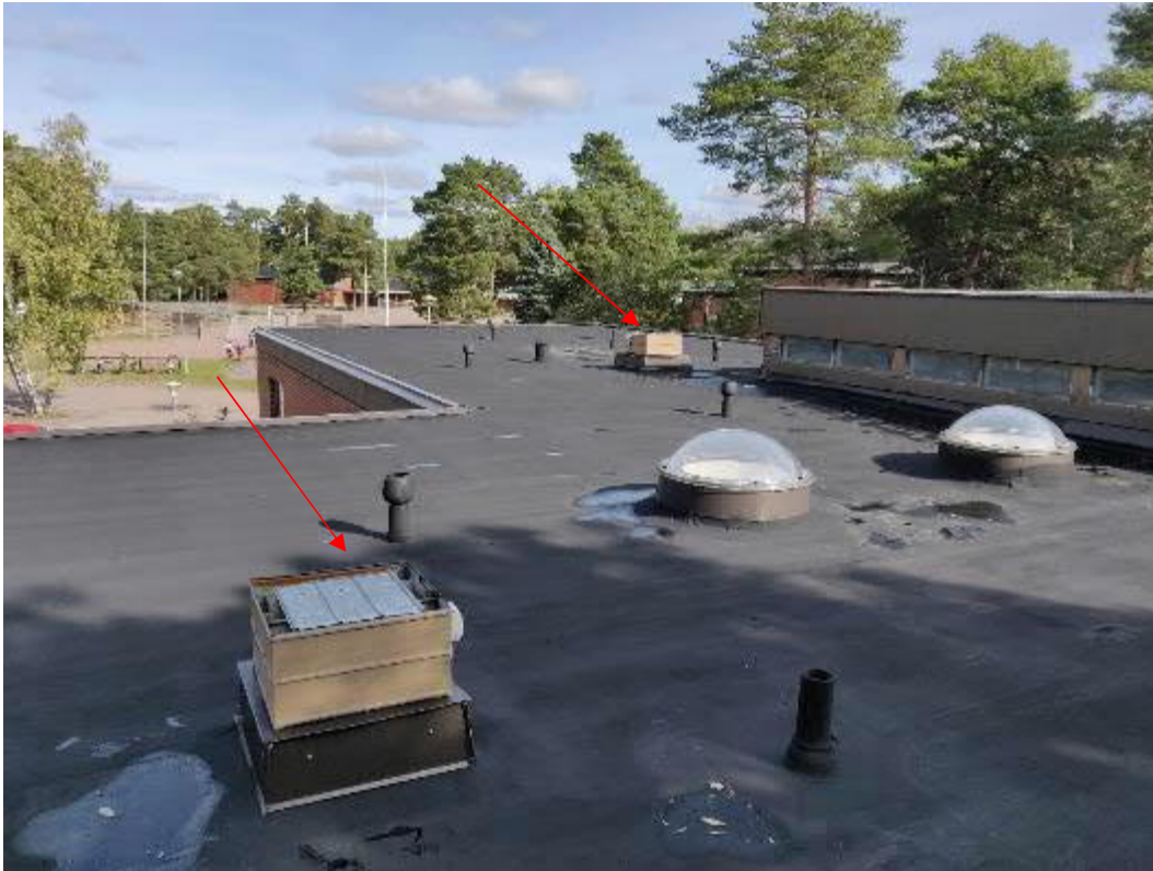
Kuva 80. Poistoilman huippumurit katolla.
