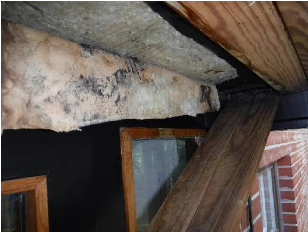
Kuva 70. Tuulikaapin yläpohjarakenne oli märkä ja silminnähden mikrobivaurioitunut.
