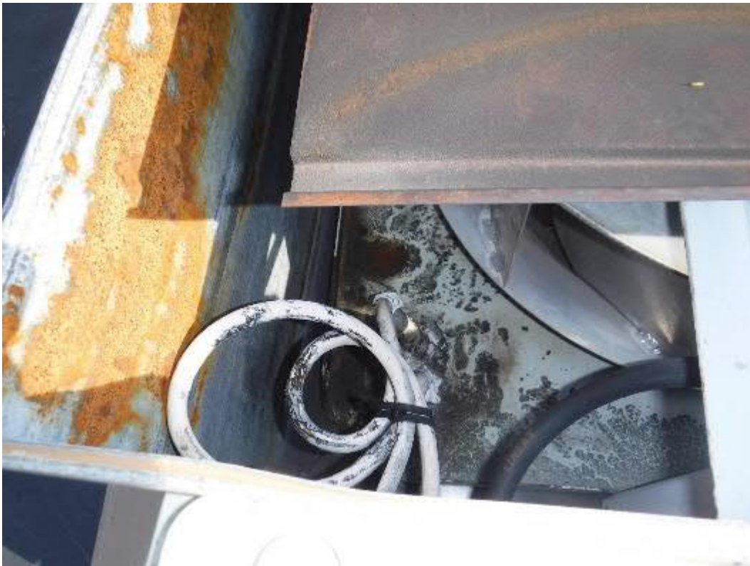
Kuva 81. Huippumurin kotelossa sähköjohdon läpivienti oli epätiivis.
