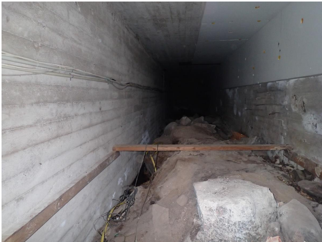
Alapohjan ontelossa havaittiin märkää orgaanista materiaalia (osittain lahonnutta) sekä irtovettä. Tilassa oli havaittavissa voimakas mikrobimainen haju.
