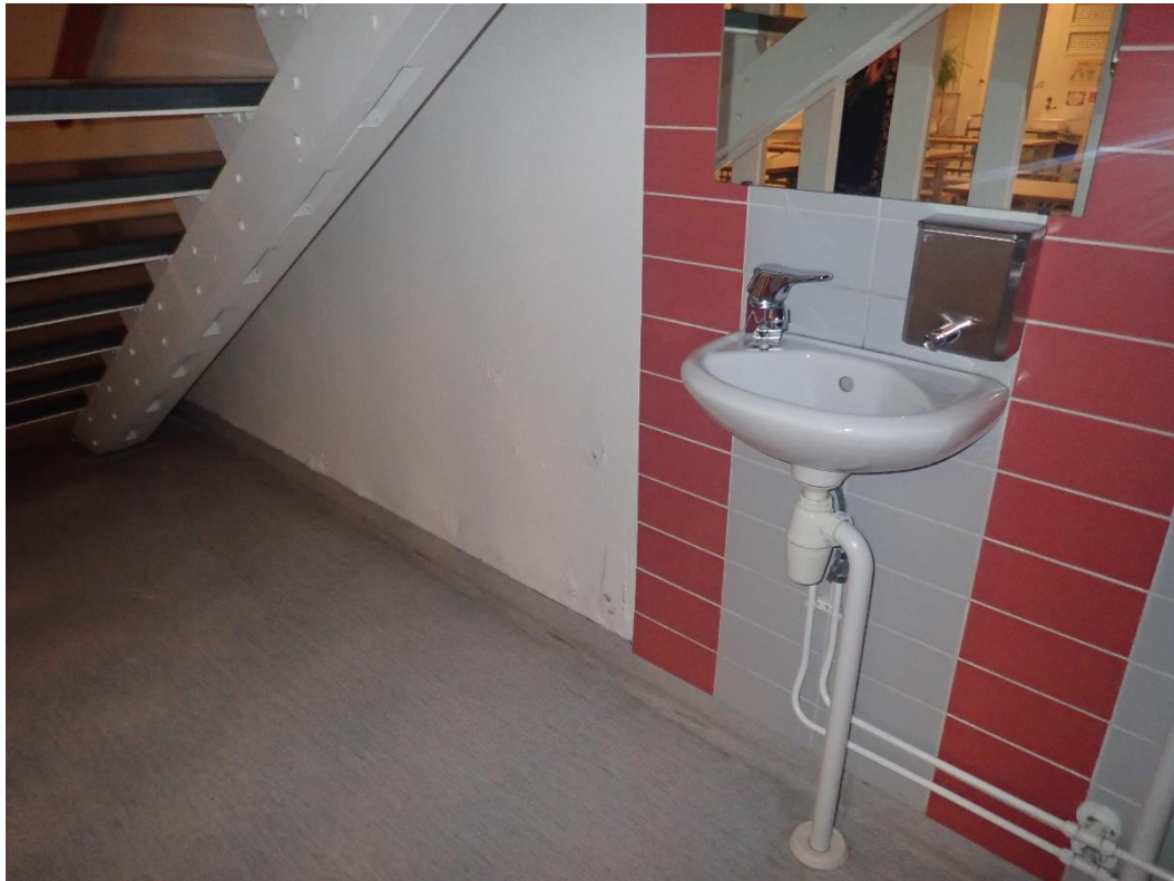
Kellarikerroksen seinissä havaittiin kosteuden aiheuttamaa pinnoitteiden irtoilua.
