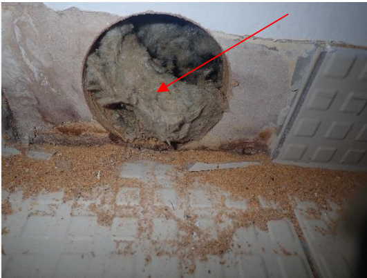
Näyte KM11 otettiin keittiön ja alustatilan välisestä seinärakenteesta. (RA7) Näytteenottokohdalla havaittiin selkeitä kosteuden aiheuttamia vaurioita.
