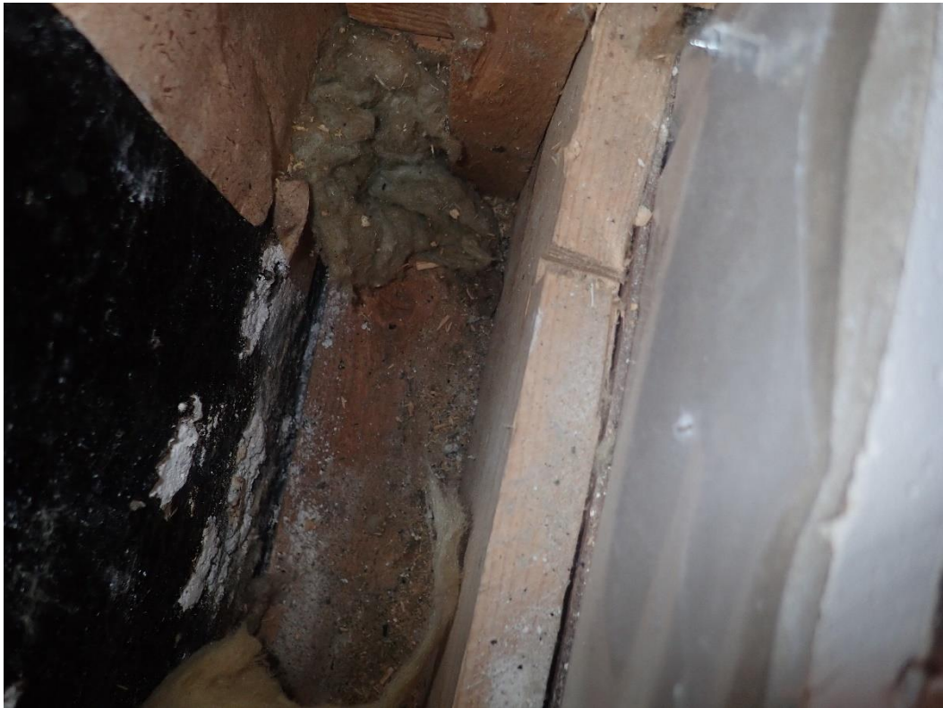
Rakeneavauksista oli aistinvaraisesti havaittavissa kosteuden aiheuttamia jälkiä, Kosteus oli mittaushetkellä koholla (kuraattorin huone, RA1).
