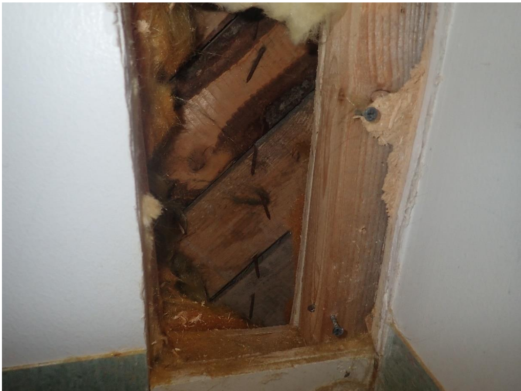
Luokkahuoneiden puolella julkisivuverhouksen takana ei ole tuuletusrakoa, eikä rakenteissa ole höyrynsulkua.
