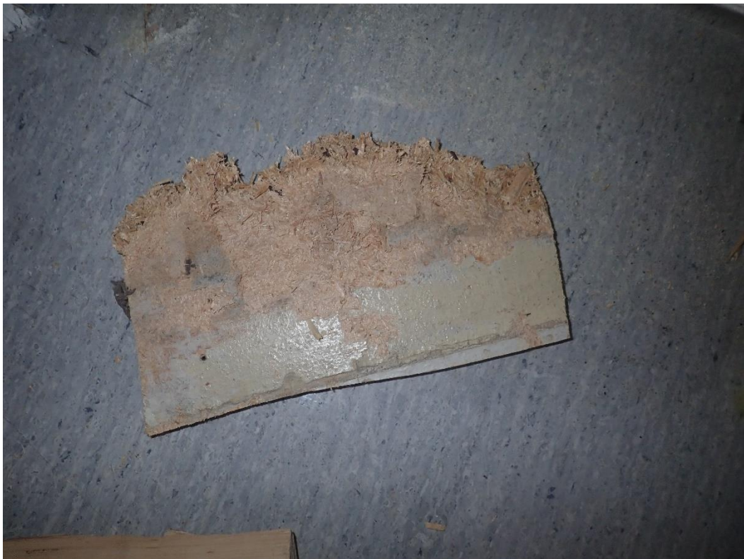
Vanhan sisäverhouslevyn alaosassa on kosteuden aiheuttamia jälkiä. Rakenteessa oli havaittavissa voimakas mikrobimainen haju (Käytävä, RA3).
