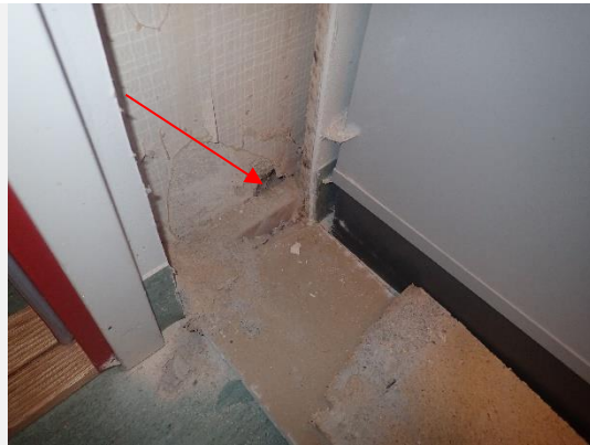
Näyte KM12 on kellarikerroksen väliseinärakenteesta. Rakenneavauksesta (RA8) tuli avattaessa hyvin voimakas mikrobimainen haju.
