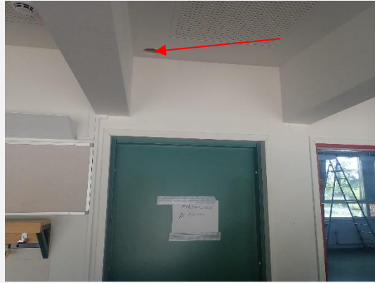
Näyte N2 otettiin käytävän yläpohjan rakennevaivasta.
