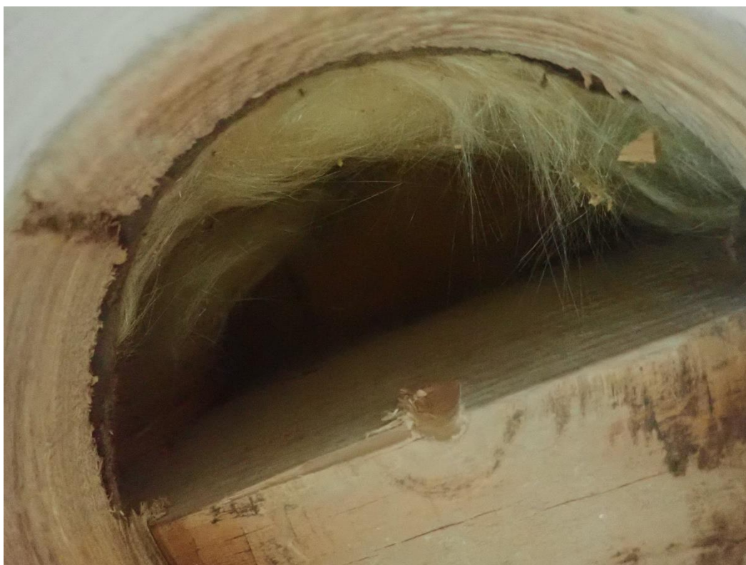
Osassa avauksia havaittiin vanhempaa mineraalivilla eristettä.
